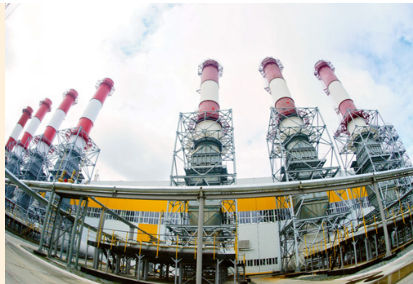
▲ Газотурбинная электростанция на Приобском месторождении
